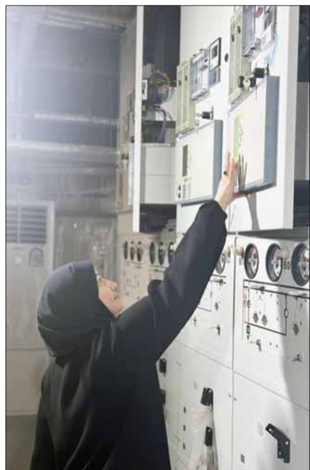
وكيل المشاريع الكبرى مريم الكندري تطلق التيار الكهربائي في المشروع
